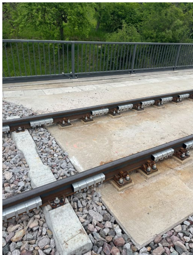
Bild 3: Eingebaute Schienenstegdämpfer im Übergangsbereich Strecke zur Brücke bei der Hermann-Hesse-Bahn
