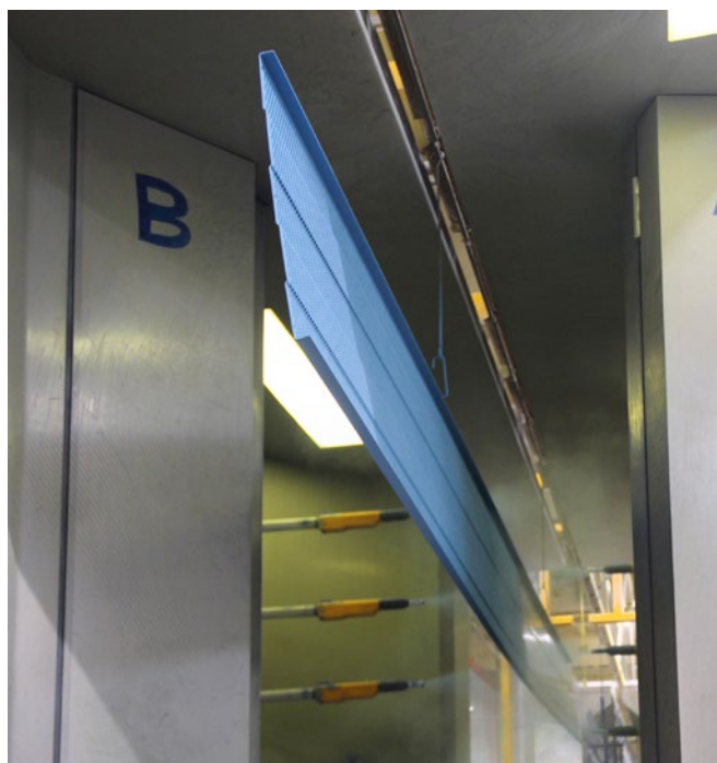
Pulverbeschichtung mit Energie aus erneuerbaren Rohstoffen – die Pulverbeschichtungsanlage im Werk St. Peter/Au wird durch die neue Energiezentrale mit der notwendigen Prozesswärme versorgt.
